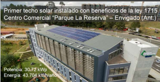
Sistemas Solares Fotovoltaicos - Resultados
