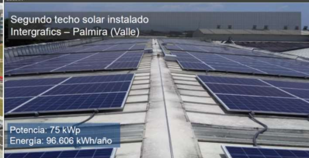
Sistemas Solares Fotovoltaicos - Resultados
